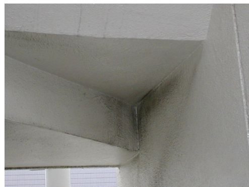
写真-9 G 建物 塵埃の蓄積による汚れ状況
