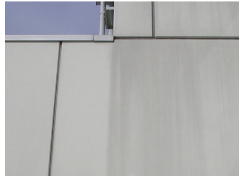
写真-2 A建物 外壁面の汚染状況
