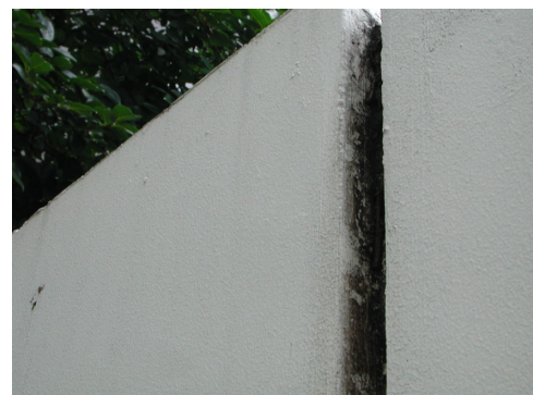
写真-5 D建物 落とし目地の汚れ状況
