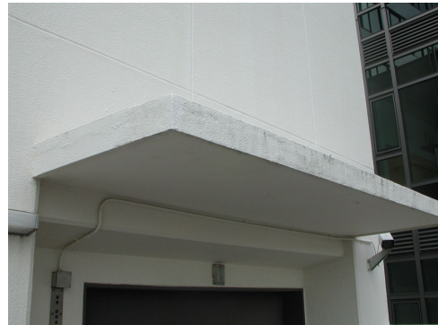
写真-6 E 建物 庇鼻先の汚れ状況
