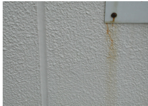
写真-7 E 建物 錆汁による汚れ状況
