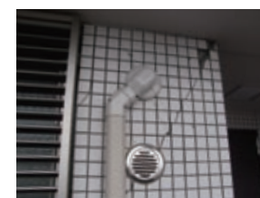
非構造部材の破損
