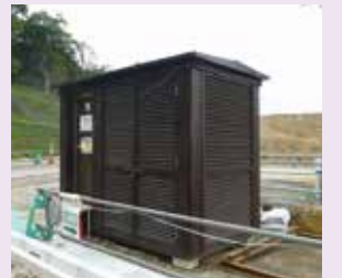
当社作業所に設置中のバイオトイレ
