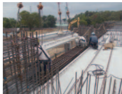
上:柱梁一体地組み・戸境壁筋地組みヤード 下:外床プレキャストコンクリートセット状況
