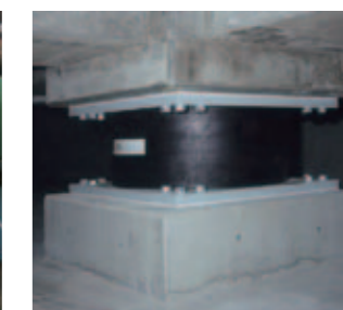
積層ゴム系免震装置 水平方向の変形抑制と復元機能を受け持つ(LRIとNRIの2種類を設置)
