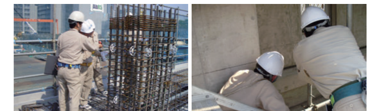
コンクリート打設前の型枠や配筋のチェック コンクリート打設状況のチェック
