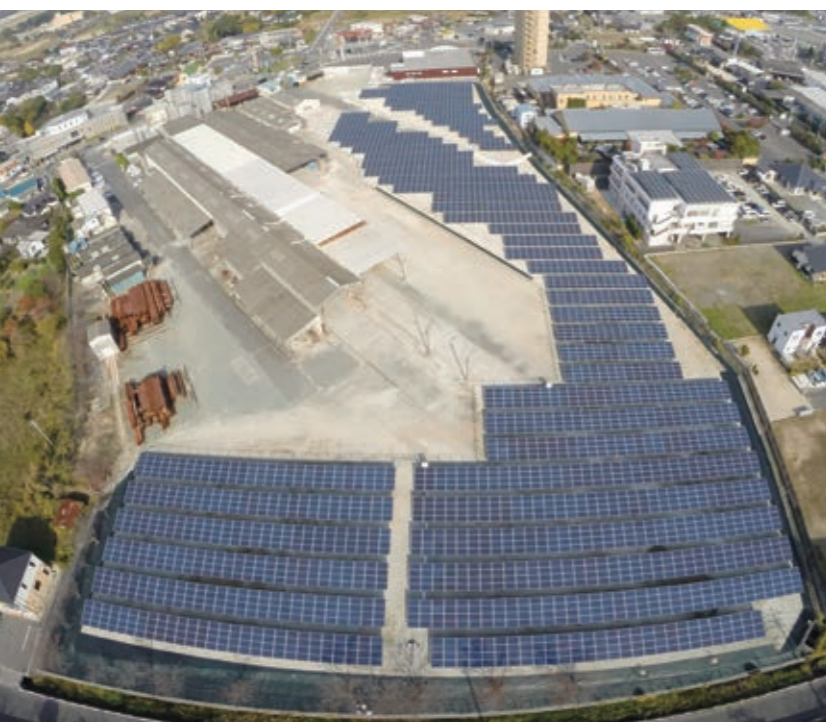
三田川太陽光発電所
