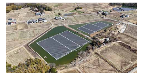
加東市（平池・新池）水上太陽光発電所
