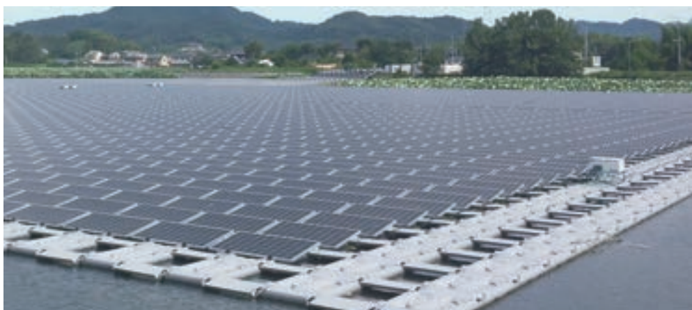
ため池に浮かぶ太陽光パネル
