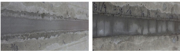
写真-2 雨上がり 接合目地部底面の様子
