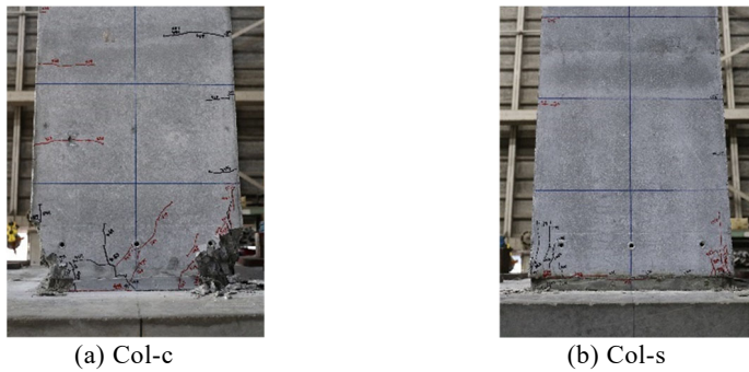
写真-2 最終破壊状況
