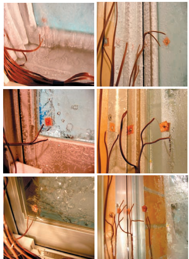
写真-2 二重窓の外窓に生じる結露（霜）
