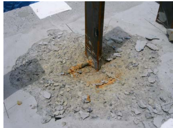
写真-1 破壊状況 (C1-T)
