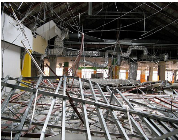
写真-1 大空間の天井脱落被害
