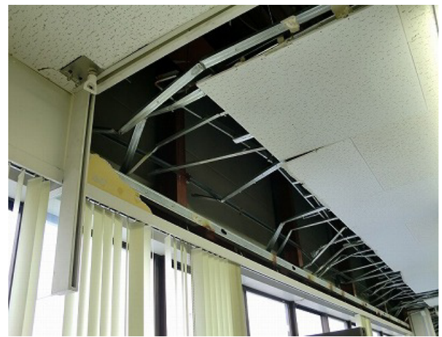
写真-2 吊天井と外壁取り付け部の損傷
