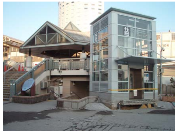
写真-1 新浦安駅前 EV 周辺の地盤沈下
