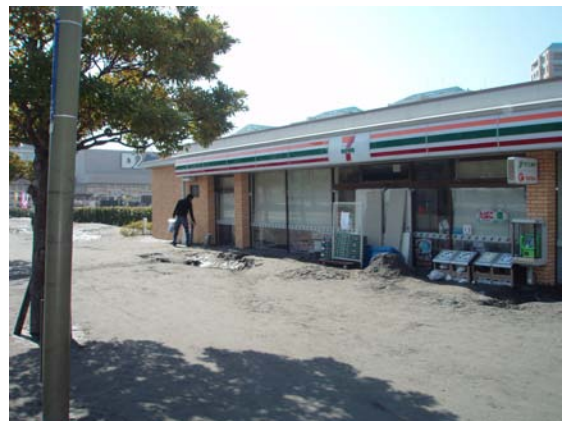
写真-2 新浦安地域のセブンイレブンの液状化被害
