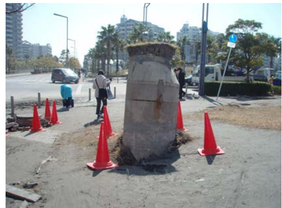
写真-3 新浦安地域のマンホールの浮き上がり
