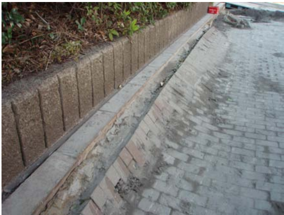
写真-6 新木場地域の歩道の沈下
