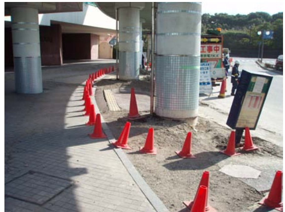
写真-9 舞浜駅前のデッキ柱脚周辺の被害状況
