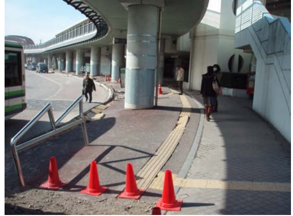
写真-7 舞浜駅前の液状化による歩道の被害
