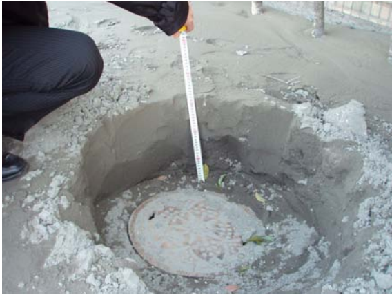
写真-4 新木場地域のマンホールの噴砂の堆積
