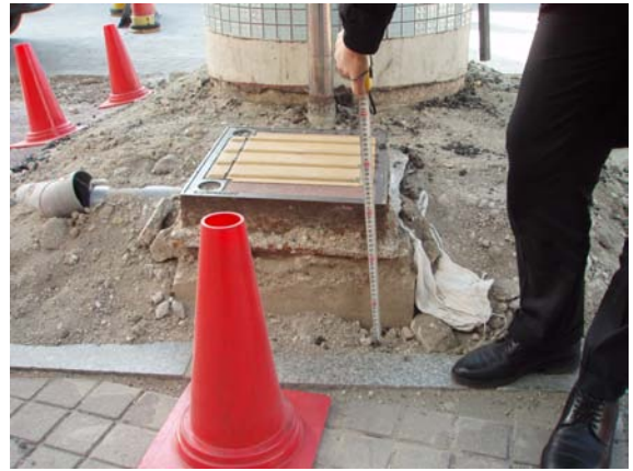
写真-8 舞浜駅前の歩道の沈下、浮き上がり
