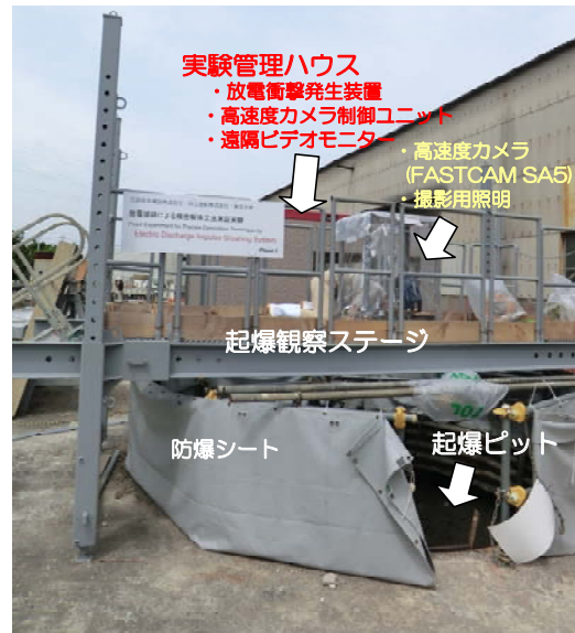
写真-2 起爆設備・実験管理設備外観
