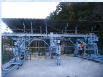
3 主桁移動作業車
