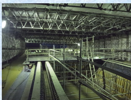
全天候養生設備内部
