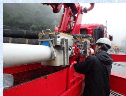
COARA 設置状況
