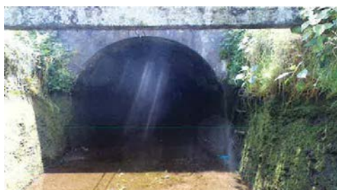
【藻類が繁殖する導水路トンネル】
