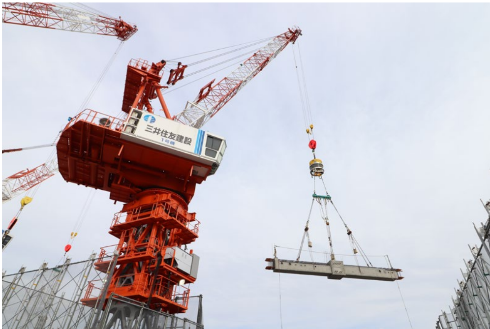
【運転支援システムと吊荷回転制御システムを導入したタワークレーン】
