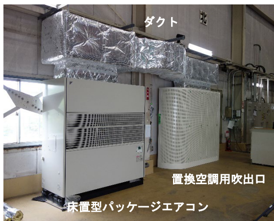
【置換空調ユニット】
