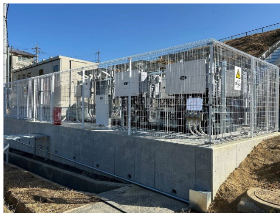
【発電施設に設置した蓄電池と非常用コンセント】
