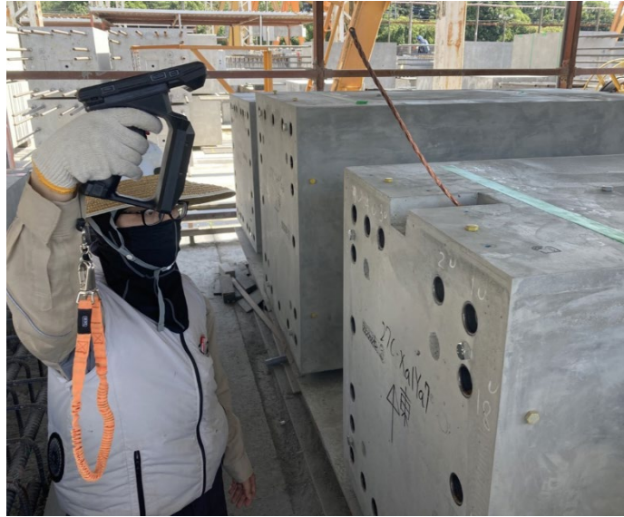
【RF タグの読み込み作業】
