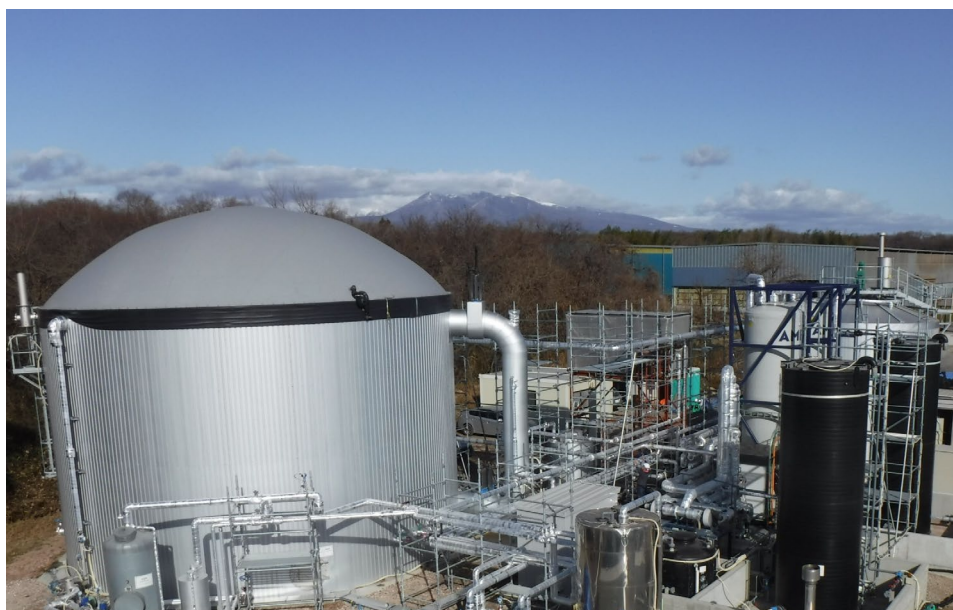
実証プラント
